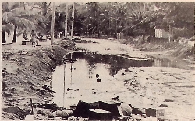
Com as chuvas foram paralisadas as obras de construção do muro de arrimo
