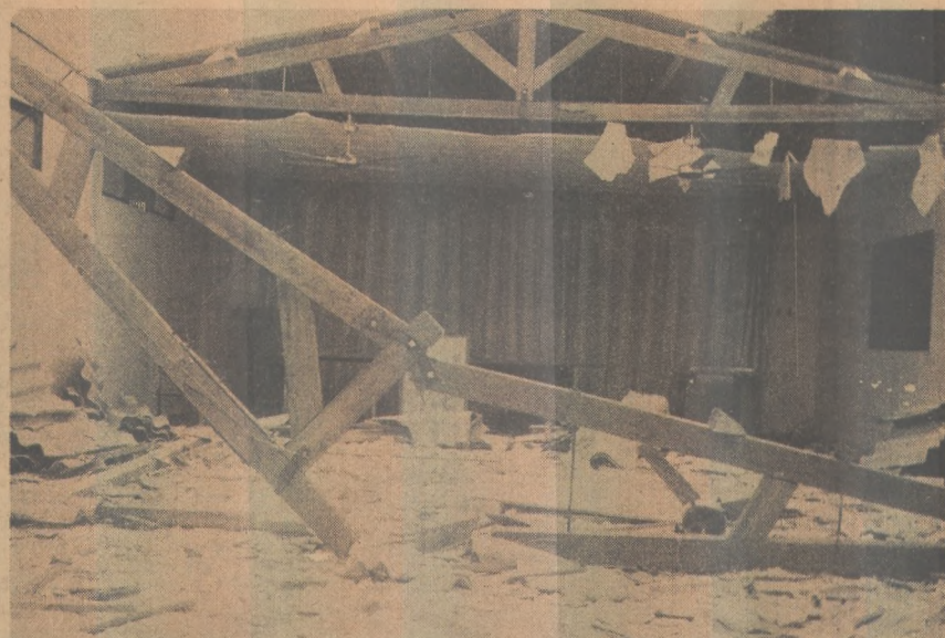
Pela terceira vez, cai o prédio da Câmara de Cajazeiras
