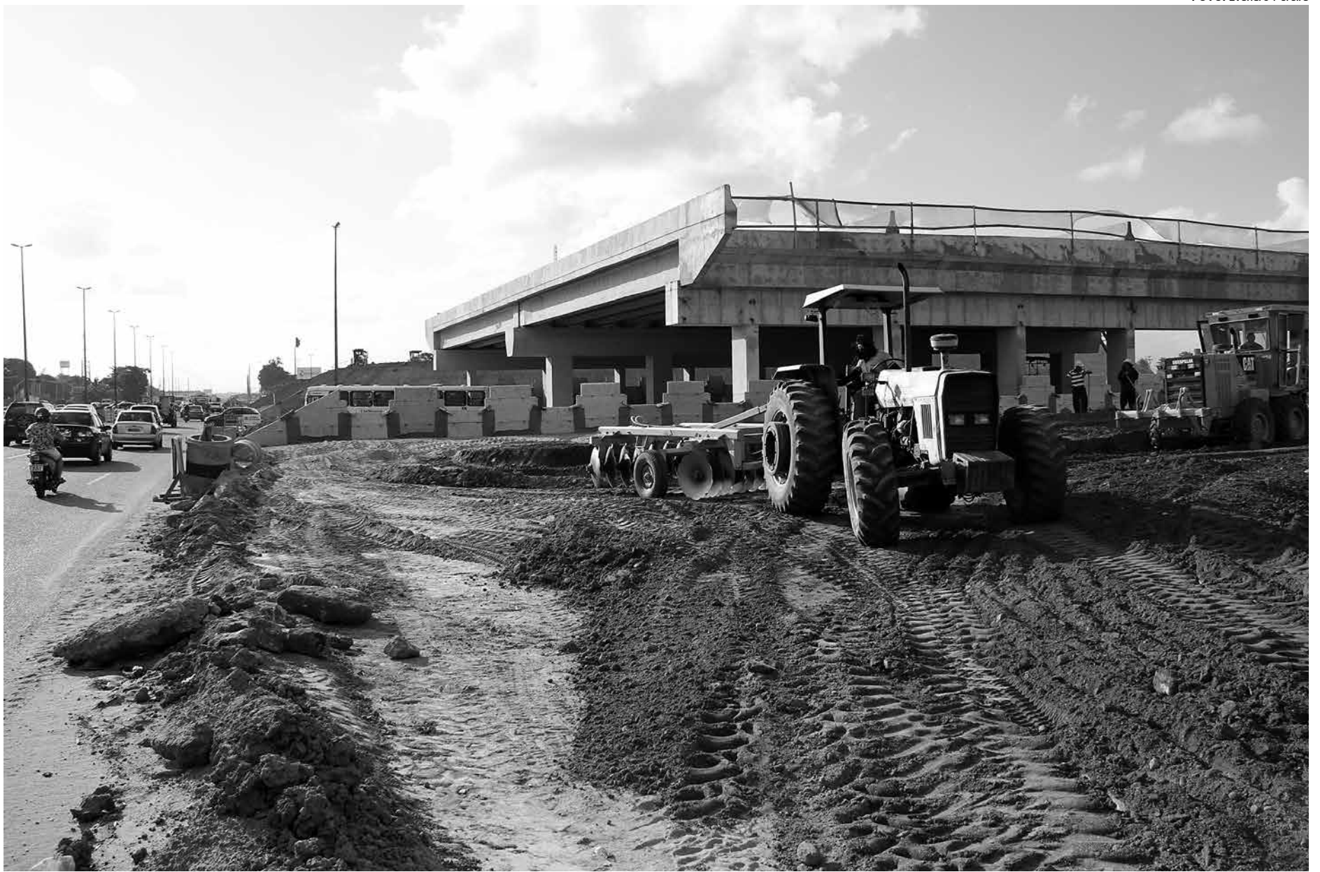
Homens e máquinas realizam trabalho em três turnos para a conclusão da obra que deverá melhorar a mobilidade urbana e facilitar a vida de milhares de pessoenses
